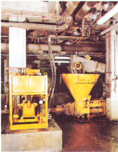
SCHWING Dickstoffpumpe KSP 45 mit 75 kW Antriebsaggregat von SCHWING unter den Kammerfilterpressen
